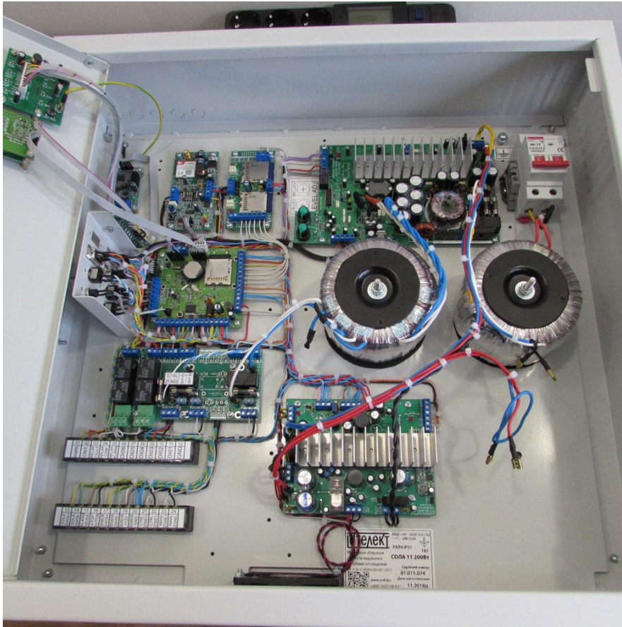
Малюнок 3.1 Загальний вигляд моноблоку СОЛА 11 200Вт з відкритими дверцятами
